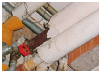
Asbesthaltiger Mörtel zur Rohrisolation
