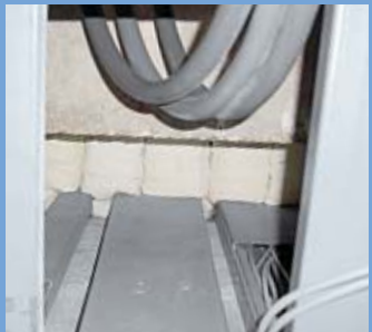
Brandabschottung mit Asbestkissen
