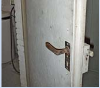
Brandschutztüre mit Asbestzement
