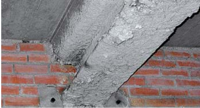
Spritzasbest an Stahlträger
