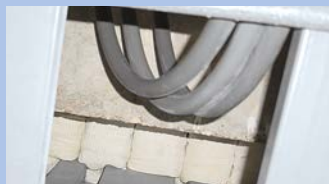
Brandabschottung mit Asbestkissen
