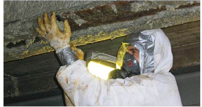
Entfernen nur durch anerkanntes Asbestsanierungsunternehmen
