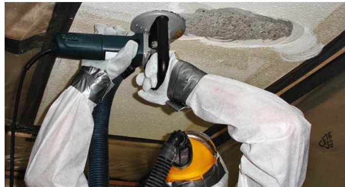
Entfernen nur durch anerkanntes Asbestsanierungsunternehmen
