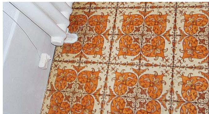
Typisches Muster eines mehrschichtigen asbesthaltigen Bodenbelags
