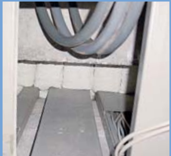
Brandabschottung mit Asbestkissen
